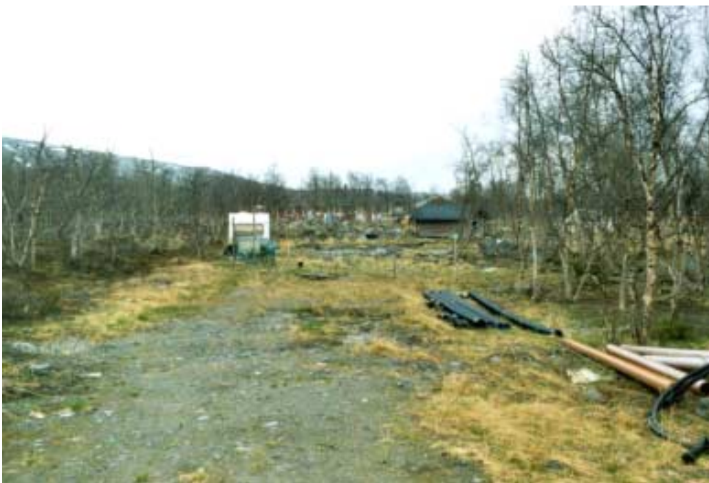
KUVA 8 JA 9. Syöpynyt oja ja kunnallistekniikan rakentamista Salmivaaran puolella.
